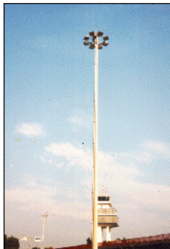
(Fig. 7.5) Torre de iluminación de plataforma de aeronaves
